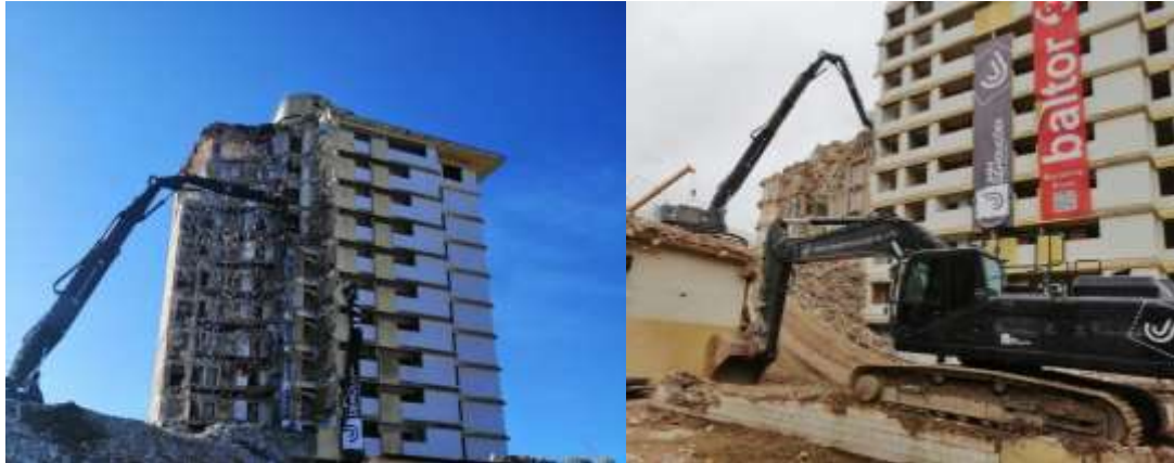
Figura 6.24 - Desconstrução da estrutura de betão armado do Edifício Coutinho com uma máquina de longo alcance
