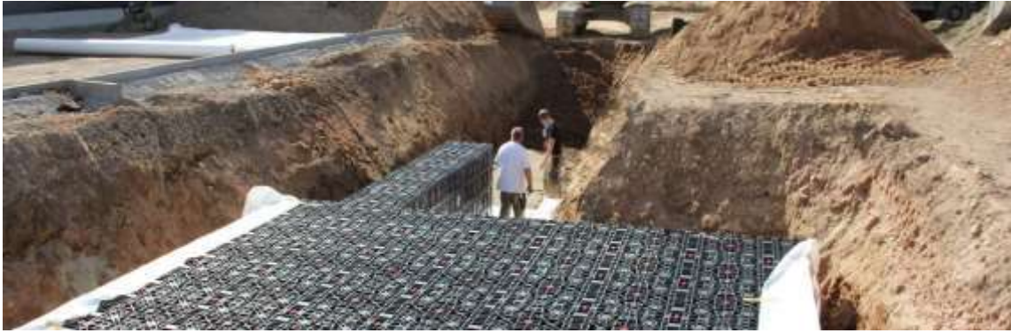
Figura 2.9 - Sistema de recolha e armazenamento de água pluvial de escorrência
