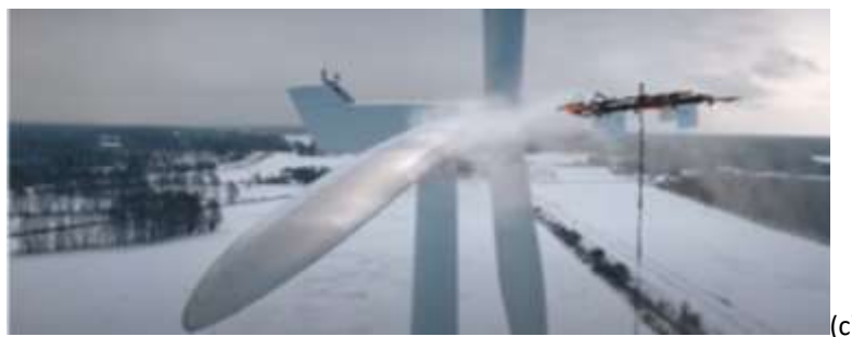
Figura 6.51 - Utilização de drones para fazer a manutenção de torres eólicas Fonte: Manutenção de turbinas eólicas com drones pesados | EngenhariaCivil.com
